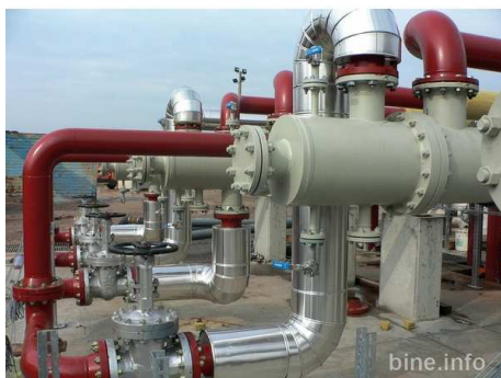
Abb.1: Teil der ORC-Anlage des geothermischen Kraftwerks in Sultz © BESTEC GmbH
